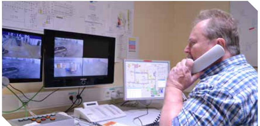
In der Leitwarte laufen die Meldungen zusammen: Manfred Funck hat alles im Blick
